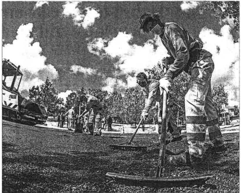
Varios operarios renovaban el asfalto el 10 de mayo en Madrid. / RODRIGO JIMÉNEZ (EFE)
